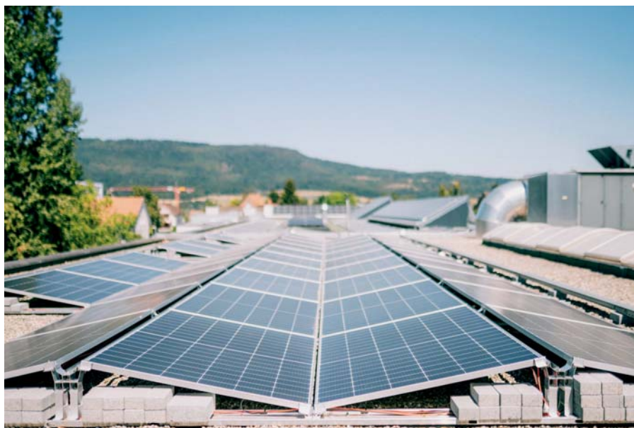
Sur le site de production, beaucoup est investi dans l'énergie et la durabilité. Outre l'installation photovoltaïque de grande surface, les nouveaux systèmes de récupération de chaleur assurent une production durable.
