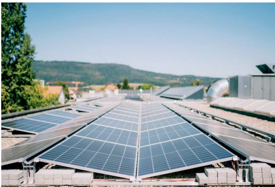
Am Produktionsstandort wird viel in Energie und Nachhaltigkeit investiert. Neben der grossflächigen PV Anlage sorgen die neuen Wärmerückgewinnungsanlagen für eine nachhaltige Produktion.
