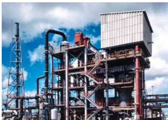
CTU arbeitet für Kunden in aller Welt. Im Bild: eine Brennkammer und eine mehrstufige Rauchgaswäsche mit HCl-Rückgewinnung in Brasilien.
