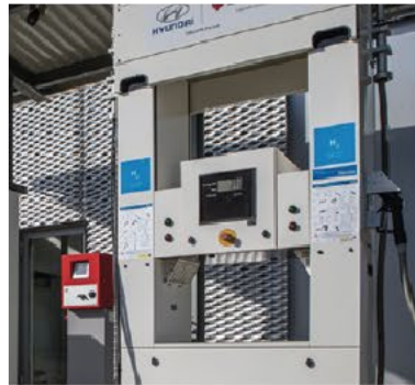
Infrastruttura stazioni di rifornimento H2
